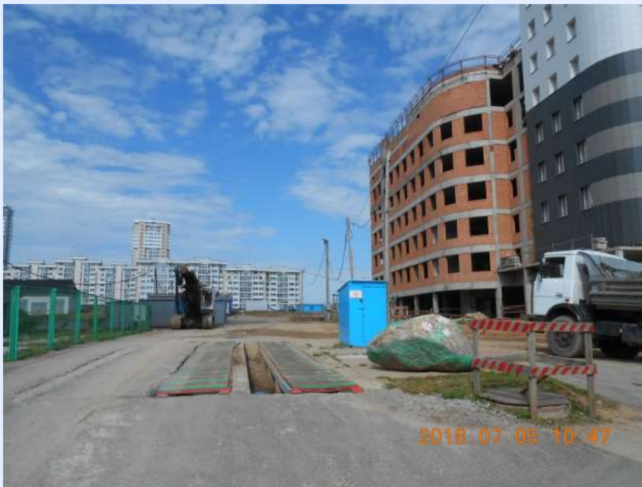
Пост мойки (очистки) колес
